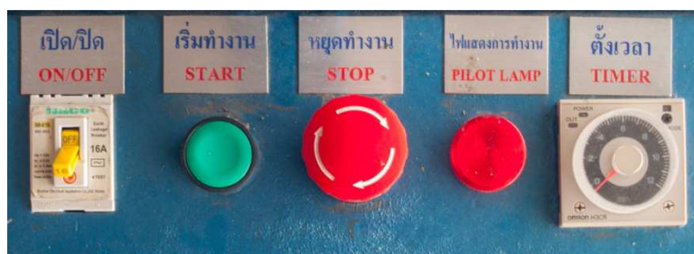
ภาพที่ 85 อุปกรณ์ควบคุมการทำงานด้วยระบบไฟฟ้า ที่มา : สมพร อ่อนเกตุพล, 2557
