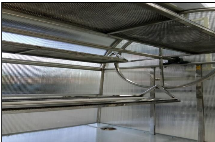
ภาพที่ 3-24 แสดง การติดตั้งชุดถาดหมุนและชุดตะแกรงของเครื่องอบปลาแก้ว
