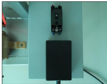
ภาพแสดง การปิด CIRCUIT BREAKER ไปที่ตำแหน่ง OFF
