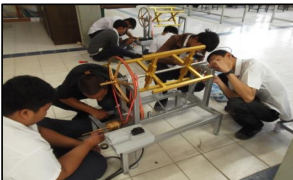
ภาพที่ 3-24 แสดง การติดตั้งและการประกอบโครงสร้างส่วนรองรับแกนเพลลาของเครื่อง
