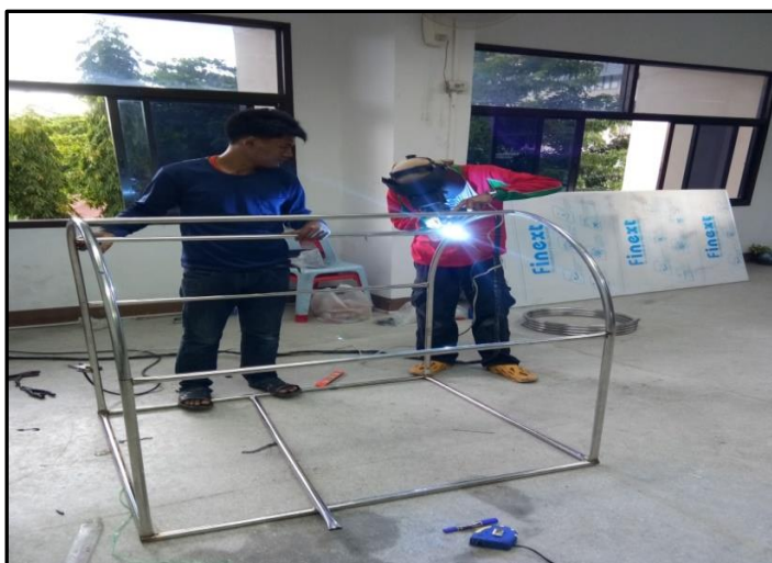
ภาพที่ 3-19 แสดง การเชื่อมประกอบเพื่อขึ้นรูปโครงสร้างเครื่อง ส่วนหลังคา
