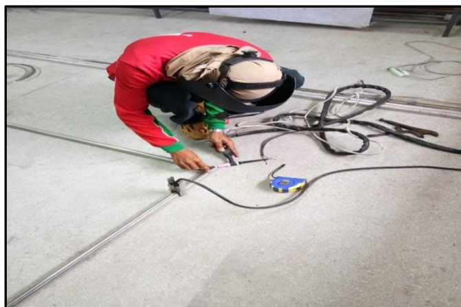
ภาพที่ 3-8 แสดง การเชื่อมต่อสแตนเลสเพื่อจัดทำโครงสร้างเครื่อง
