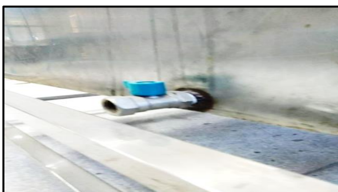
ภาพที่ 3-10 แสดงการติดตั้งท่อระบายน้ำทิ้งของเครื่อง (ที่มา : วัทัญญ บุตรศรี, 2560)
