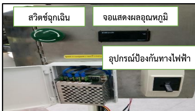
ภาพที่ 3-68 แสดงอุปกรณ์ควบคุมหน้าตู้ควบคุมไฟฟ้า (ที่มา : วทัญญู บุตรศรี, 2561)
