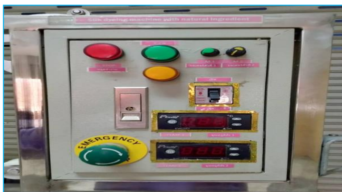
ภาพที่ 3-149 แสดงด้านหน้าของตู้ควบคุมระบบไฟฟ้า (ที่มา : วทัญญู บุตรศรี, 2562)
