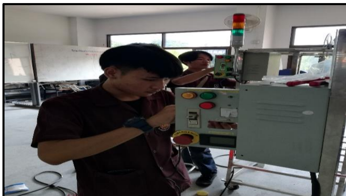
ภาพที่ 3-134 แสดงตู้ควบคุมระบบไฟฟ้าที่ติดตั้งเข้ากับโครงสร้างเครื่อง (ที่มา : วทัญญู บุตรศรี, 2562)
