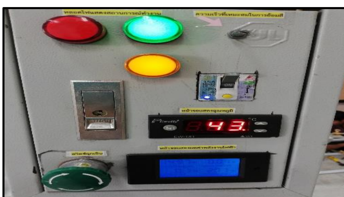
ภาพที่ 3-96 แสดงด้านหน้าตู้ควบคุมระบบไฟฟ้าของเครื่อง (ที่มา : วัทัญญ บุตรศรี, 2561)
