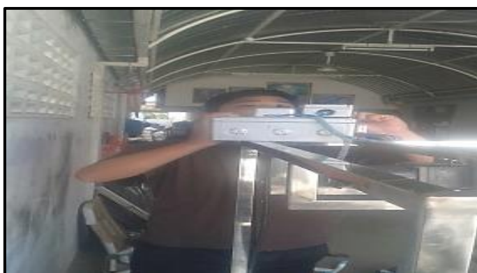
ภาพที่ 3-15 แสดงการติดตั้งตู้ควบคุมระบบไฟฟ้าในการทำงานของเครื่อง (ที่มา : วัทัญญ บุตรศรี, 2560)
