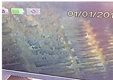
ภาพที่ 3.22 ตรวจสอบชุดคอยล์เย็นก่อนทำการล้างด้วยกล้อง Snake Scope
