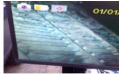
รูปที่ 13 ใช้กล้อง Snake Scope ตรวจสอบความสะอาดชุดคอยล์เย็นอีกครั้งผ่านจอมอนิเตอร์ก่อนทำการประกอบอุปกรณ์อื่นๆ
