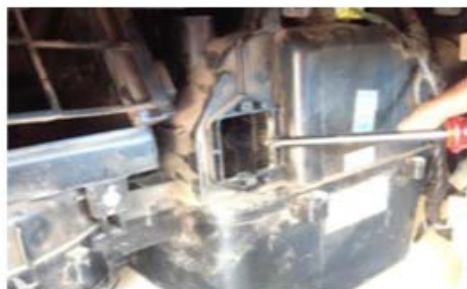
รูปที่ 7 ถอดเทอร์โมสตัทออกก่อนทำการตรวจสอบและล้างทำความสะอาดชุดคอยล์เย็น
