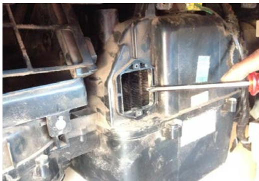
ภาพที่ ค.15 สภาพชุดคอยล์เย็นก่อนทำการล้างทำความสะอาด
