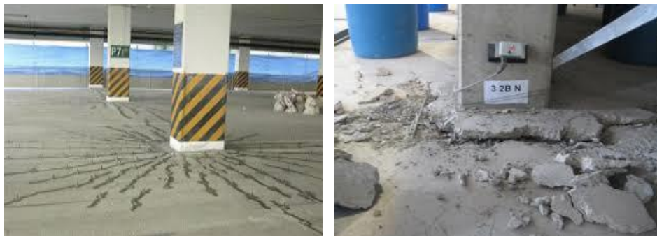
รูปที่ 3.27 (ก)-(ข) การวิบัติโดย แรงเฉือนทะลุ (Punching Shear)
