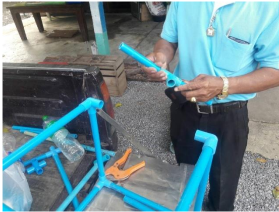
ภาพแสดงลักษณะการตัดท่อพีวีซีตามขนาดเพื่อประกอบเป็นตัวโครงสร้าง
