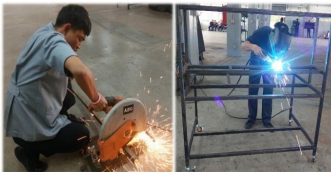
ภาพที่ 3.3 แสดงภาพการตัดเหล็กตามแบบ และการเชื่อมประกอบขึ้นโครงชุดฝึก ฯ
