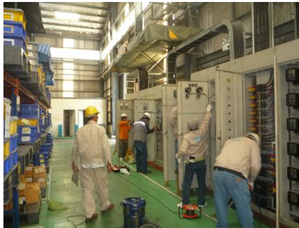
รูปที่ 6.12 พนักงานทำการตรวจสอบบำรุงรักษาตู้จ่ายไฟ 12
