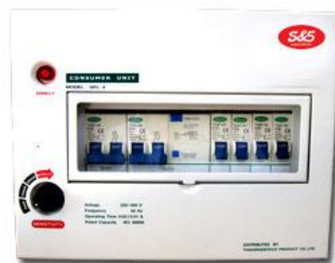
รูปที่ 1.4 แผงจ่ายไฟฟ้าสำหรับที่อยู่อาศัย
